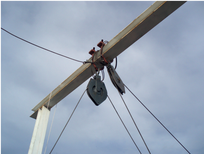
Imágenes 53, 54 y 55. Ventiladores, campana y poleas.
