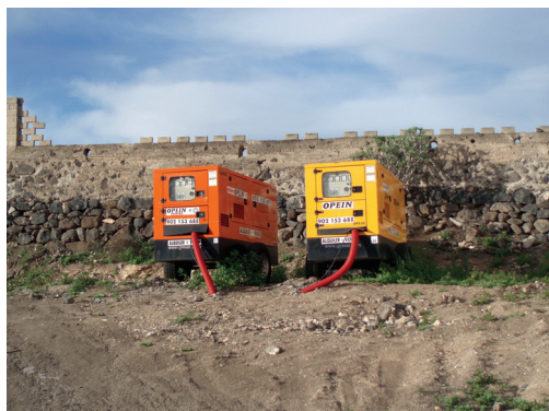
Imagen 56. Vista de los equipos electrógenos.
